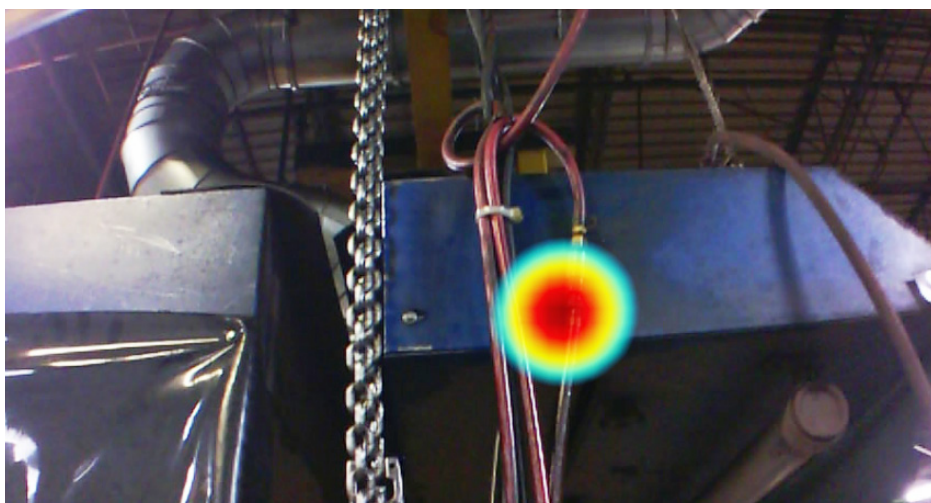
Bild tagen med ii900 Industrial Acoustic Imager av ett luftläckage i industriell miljö.
